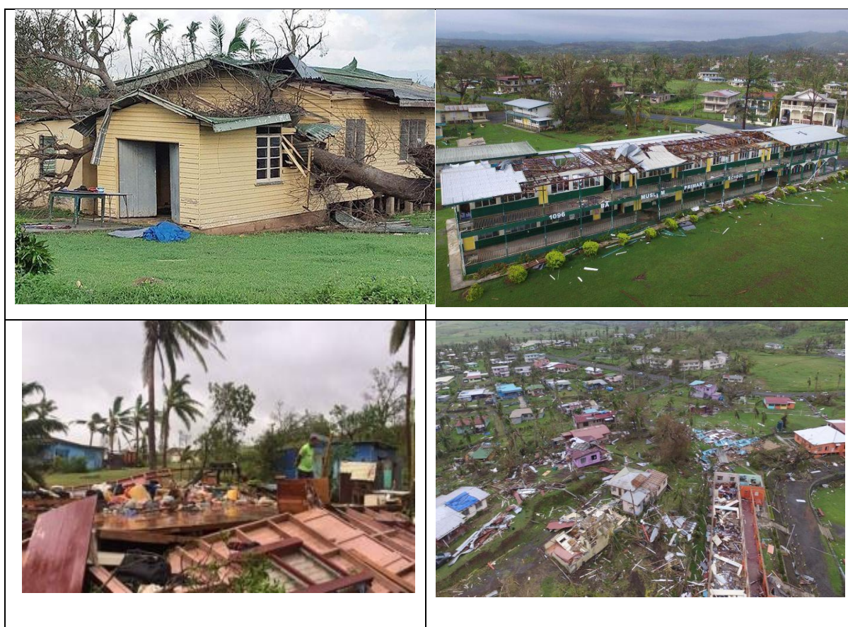
圖357 當地建物遭受嚴重破壞
