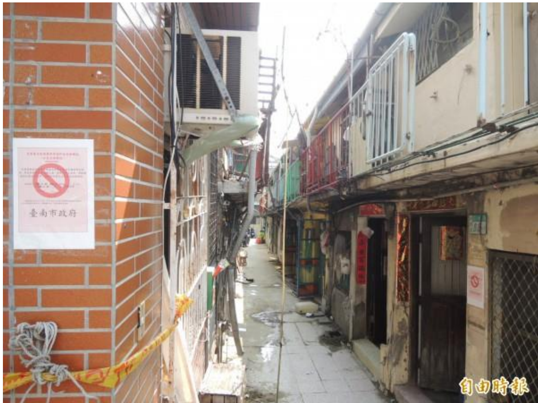
圖349 危險建築物緊急評估累計通報 6573 件。
