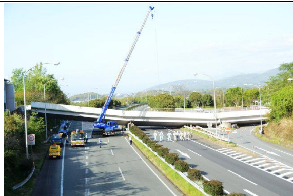
圖398 高速公路橋體掉落
