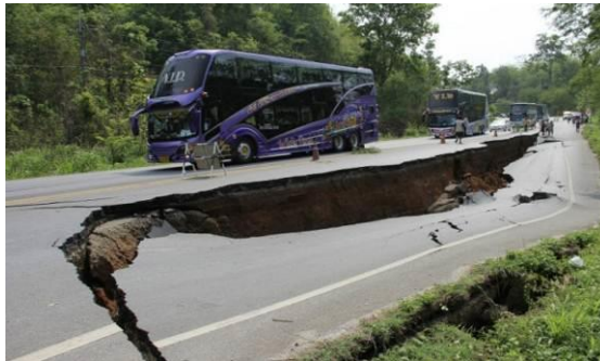
公路受地震影響受損情形
