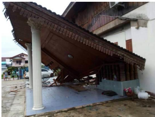
寺廟外屋頂倒塌
