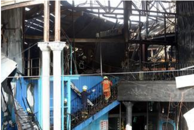
圖166 爆燃產生導致鐵皮熔塌
