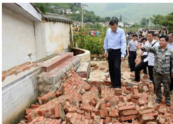
圖110 魯甸當地房屋抗震性能不佳
