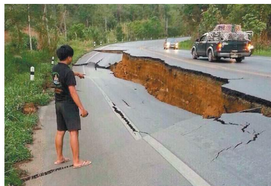
當地路面出現大裂縫
