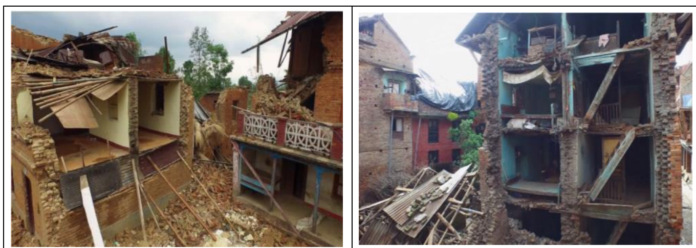
圖226 尼泊爾地震受損房屋多屬耐震能力不足之建築
